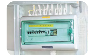
Щит собственных нужд
