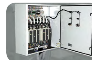
Щит автоматического ввода резерва (АВР)*
