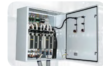
Щит автоматического ввода резерва*
