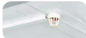
Датчик пожарной сигнализации
